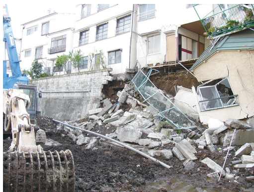
写真 2 東京都西品川における崖っぶちの崩壊 (2004 年 4 月)。画面左端の重機の振動だけで崩壊した
