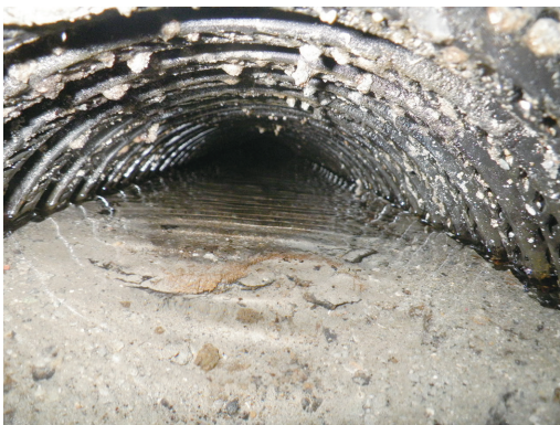
写真3 土砂で半分以上が埋積された宅地盛土底面の暗渠
