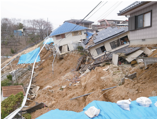
写真1 2011年東北地方太平洋沖地震による谷埋め盛土末端の宅地崩壊（福島市）
