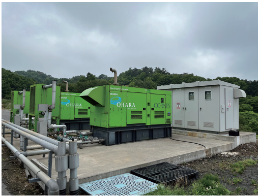
写真7：バイオガス発電の発電機。
