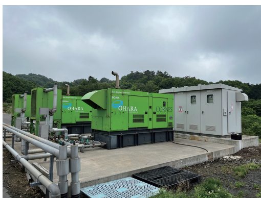
写真7：バイオガス発電の発電機。
